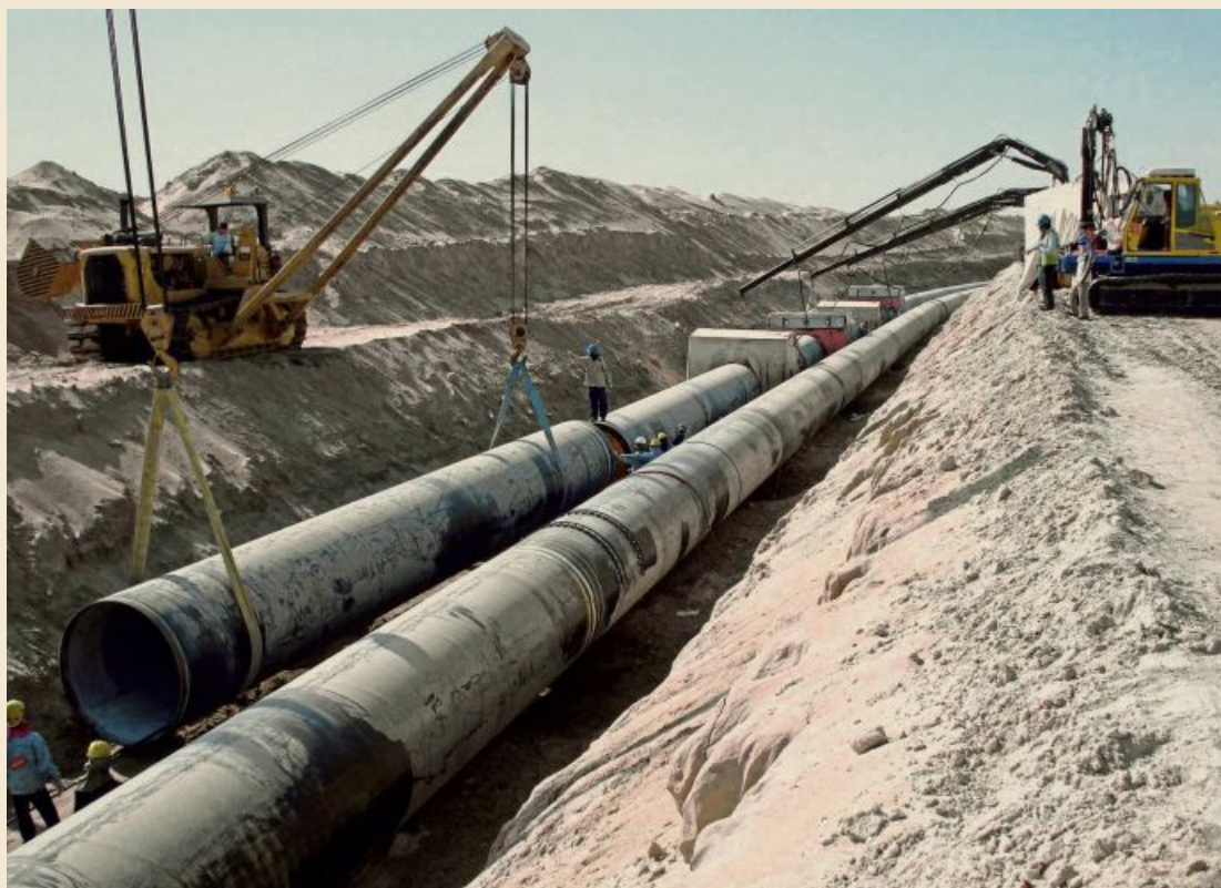
Nicht Rohöl und auch nicht Gas, sondern Trinkwasser fließt inzwischen durch dieses von ILF geplante Wassertransportsystem in Saudi-Arabien. Das Gesamtnetz umfasst 7740 Kilometer Rohrleitungen.
